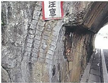
信越本線 車場川橋梁 ねじりまんぼ。 西側坑口を見ると煉瓦が四重に積み重ねているのが解る。
