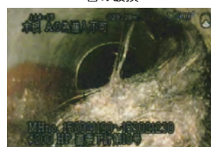
管内詰まり (木根侵入)
