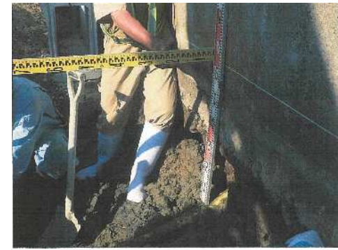
供給管（破損箇所）深さ h=620mm
