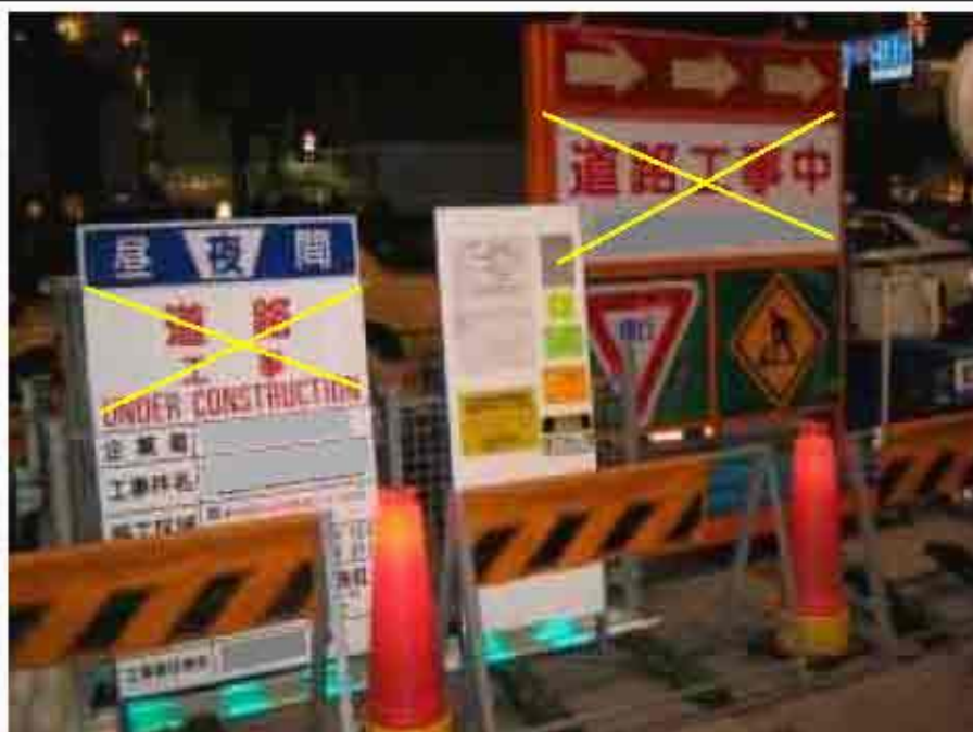
○工事種別の表示が「占用工事（地下鉄工事）」なのに「道路工事」と表示している。 ○工事中看板が設置されておらず、従来の工事標示板が設置されている。
