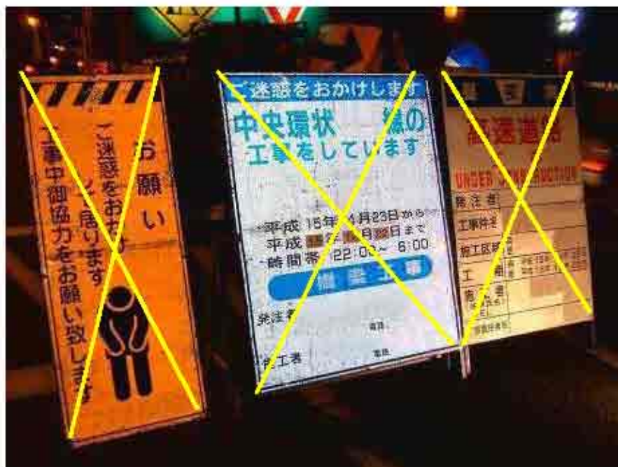
○工事中看板（新しい工事標示板）と一緒に、従来の工事標示板が設置されている。
