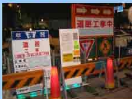
占用工事（地下鉄工事）なのに「道路工事中」と表示している。
