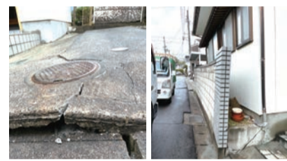
▲能登半島地震の被害
