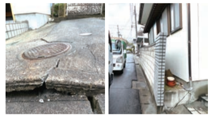
▲能登半島地震の被害
