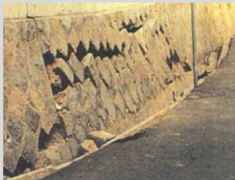
擁壁の不同沈下・目地の開き
