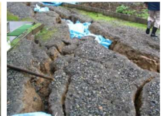
地盤の亀裂 (出典：被災宅地の調査・危険度判定マニュアル/被災宅地危険度判定連絡協議会)
