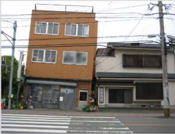
住宅の沈下・傾斜
