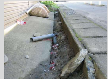
地盤の沈下・段差
