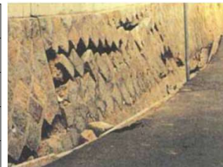
擁壁の不同沈下 (出典：被災宅地の調査・危険度判定マニュアル/被災宅地危険度判定連絡協議会)
