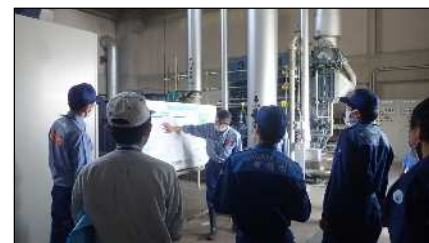
胡桃山排水機場
