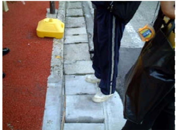
写真5.39 側溝蓋のすき間
