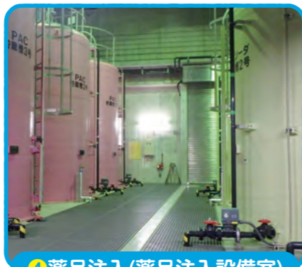
④ 薬品注入(薬品注入設備室)
