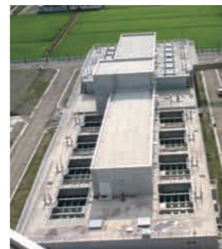
急速ろ過池(手前)と生物活性炭ろ過池(奥)
