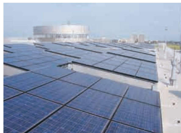
沈でん池に設置した太陽光発電パネル
