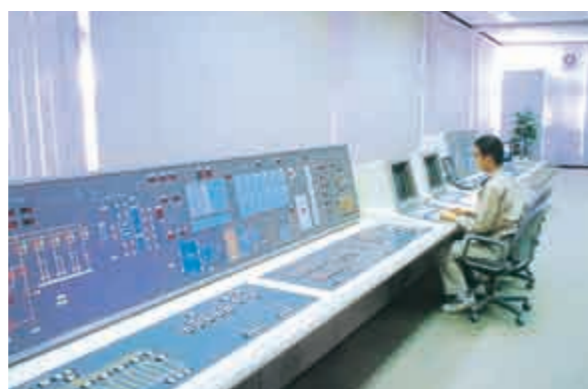
青山浄水場の中央監視室
