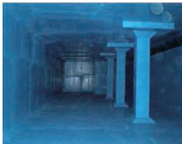
満願寺浄水場浄水池の内面防食施工(平成21年3月しゅん工)
