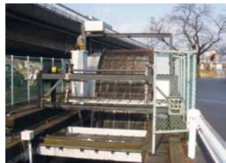
■図-23 姥ヶ山排水路除塵機
