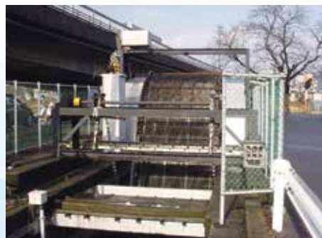
■図-23 姥ヶ山排水路除塵機
