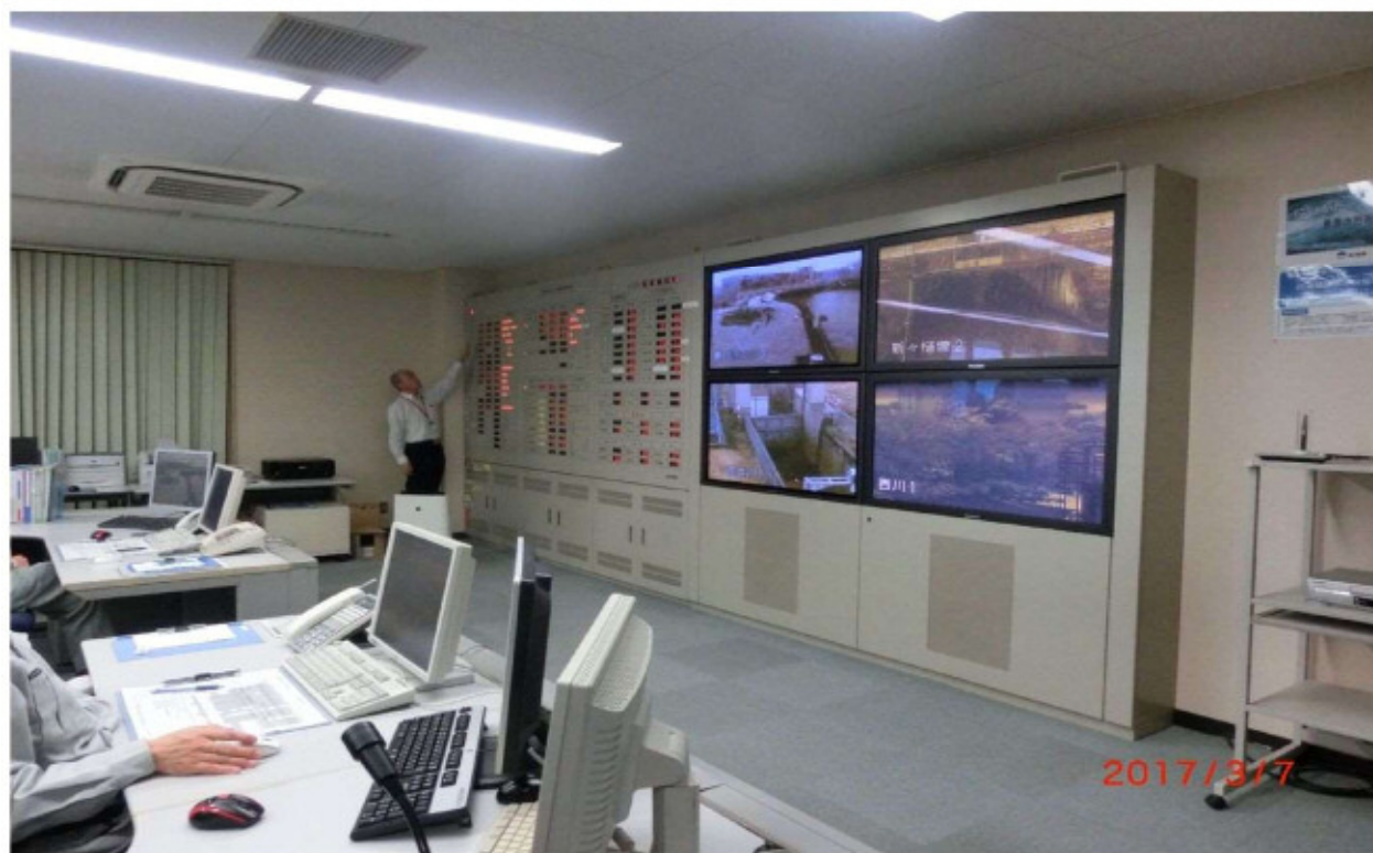
西蒲原土地改良区中央管理所内の雨水排水各施設の運転状況
