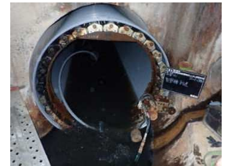
耐震化工事をした管路
