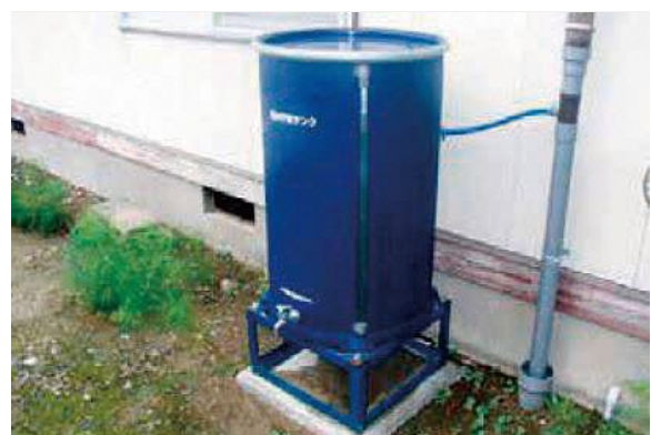
貯留タンク設置例
