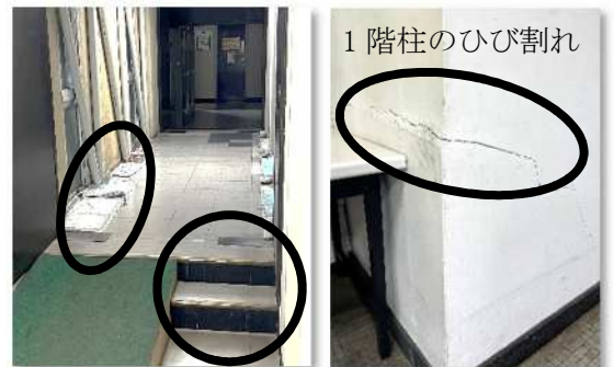
雨漏りや段差の箇所 →
