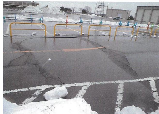
〔新田清掃センターの段差、陥没〕
