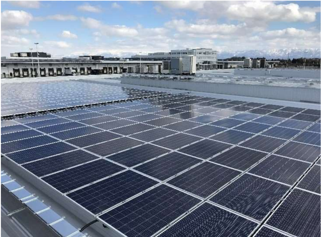
新潟市中央卸売市場に設置した太陽光パネル
